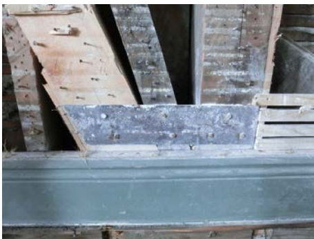
写真2 記念館で用いられていた筋かい端部の金物
